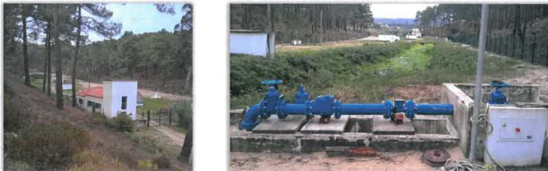
Figura 4.1. Parque de captações subterrâneas de Águas Belas
