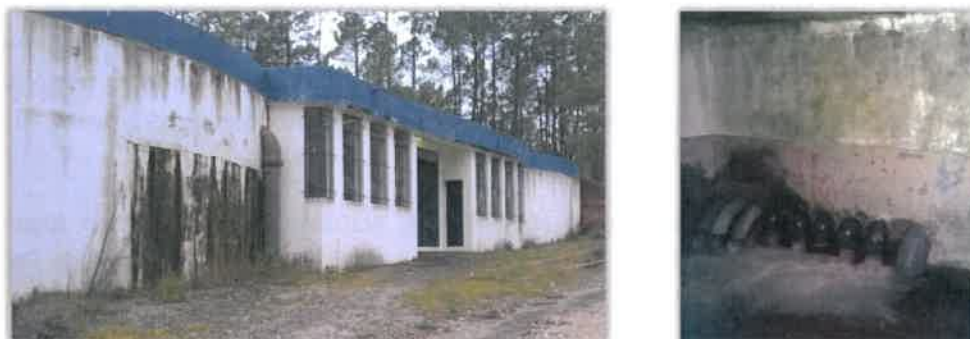
Figura 4.2. Reservatório de regularização de bombagem de Águas Belas
