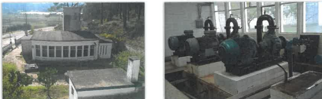
Figura 4.3. Central elevatória de Águas Belas
