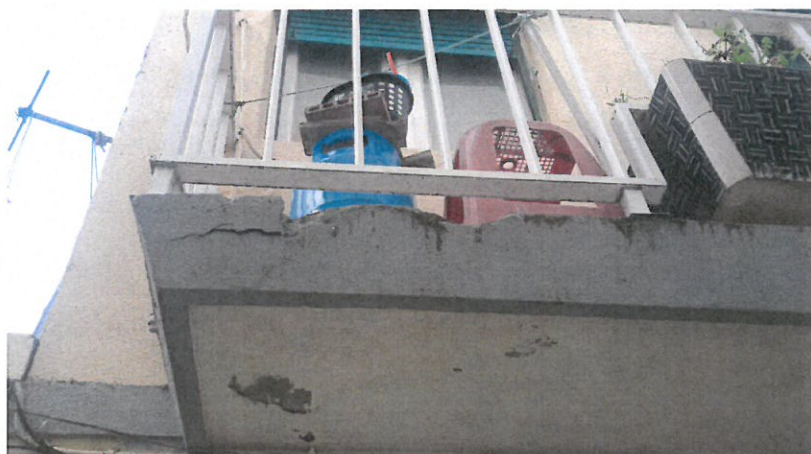
Foto n.º 3 – Bordo da laje da varanda do fogo do 1º andar
