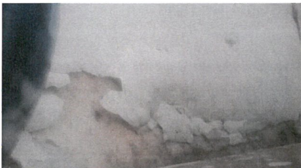
Foto n.º 1 – Teto da cozinha do fogo do 1º andar
