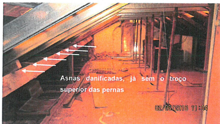
Figura 3.1 – Perfis metálicos da nova cobertura, escorados após o acidente. Asnas de madeira danificadas por corte do troço superior das pernas
