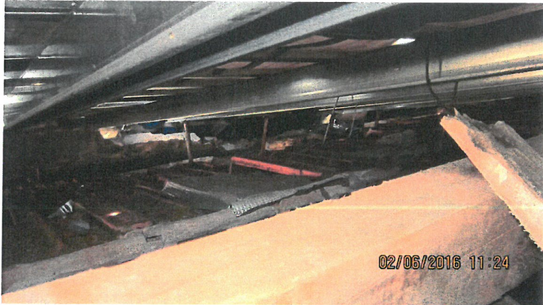
Figura 3.5 – Estrutura metálica escorada no troço de platibanda colapsada e ainda apoiada no troço de platibanda que não ruiu
