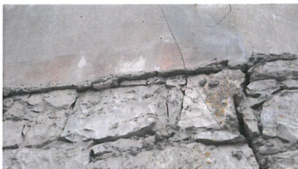
Foto n.º 4 – Fissuras verticais e deslocamento
