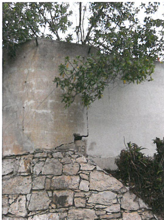
Foto n.º 2 – Fissuras verticais e deslocamento
