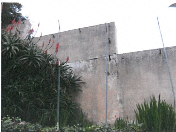
Foto n.º 3 – Fissuras verticais e deslocamento
