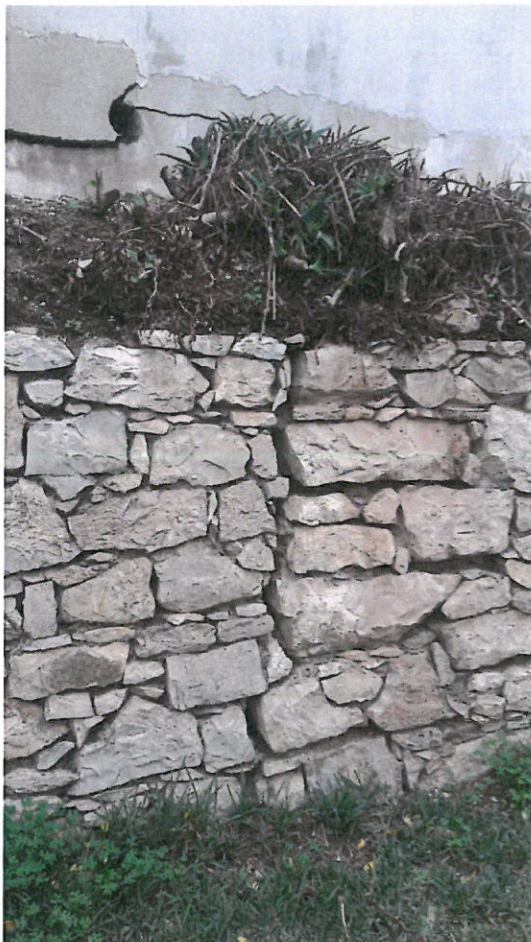
Foto n.º 1 – Fissuras verticais e deslocamento
