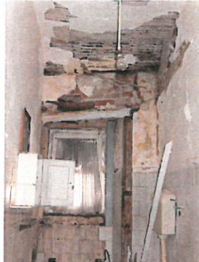
Foto n.º 8 – Instalação sanitária
