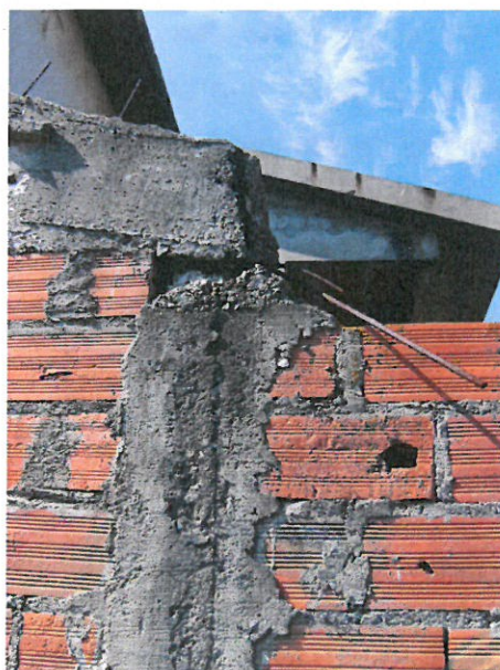
Foto n.º 4 – Deficiências dos elementos estruturais
