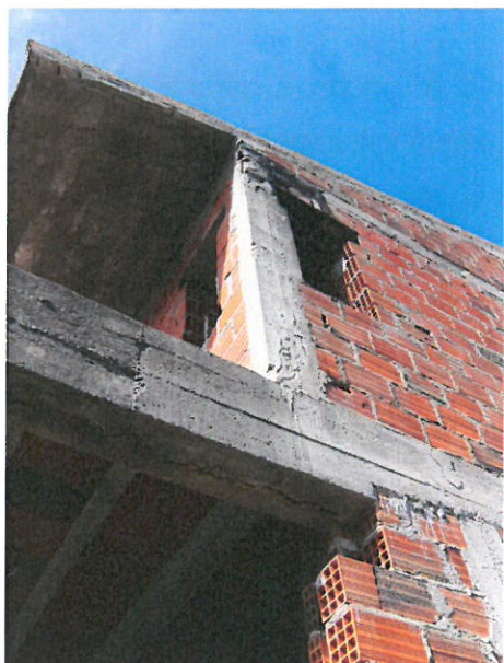
Foto n.º 3 – Fissuração nos elementos estruturais
