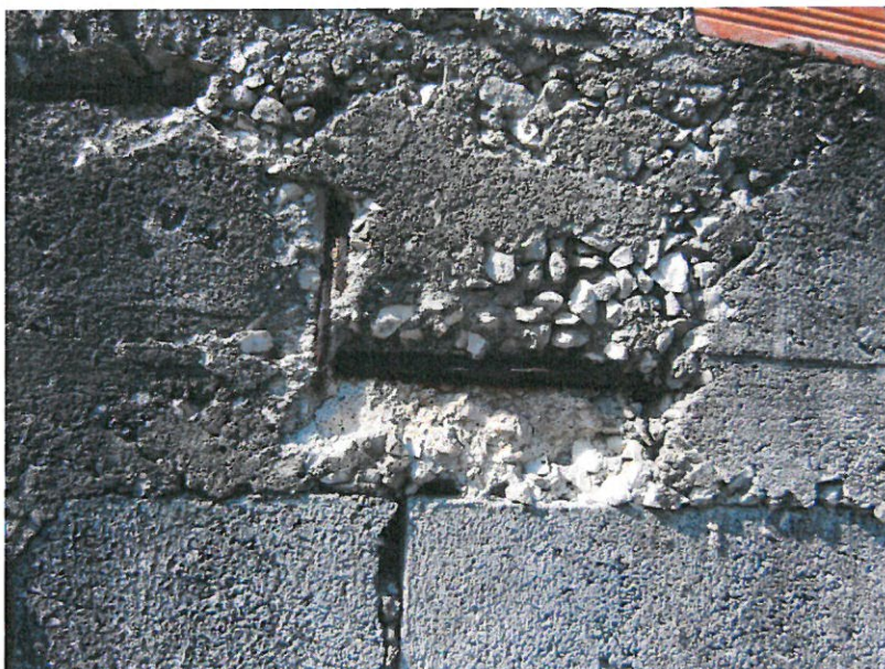
Foto n.º 5 – Deficiências dos elementos estruturais e corrosão nas armaduras
