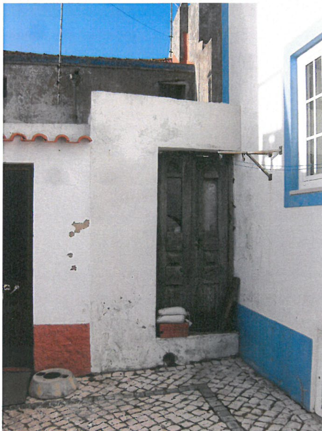
Rua Azevedo e Sousa, n.º 16, Sítio: Casa em aparente estado de abandono.
