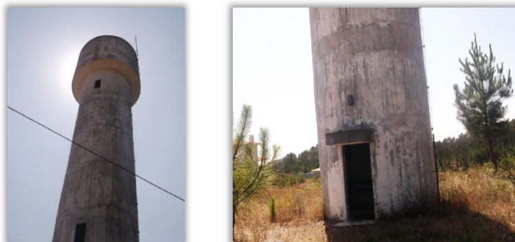
Figura 4.12. Reservatório de Fanhais
