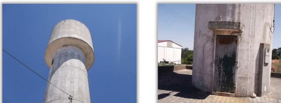
Figura 4.13. Reservatório de Raposos
