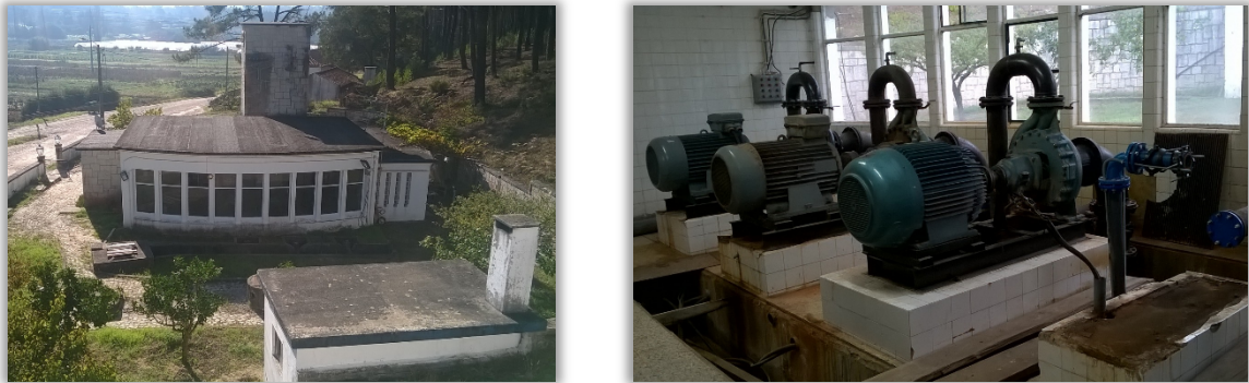
Figura 4.3. Central elevatória de Águas Belas
