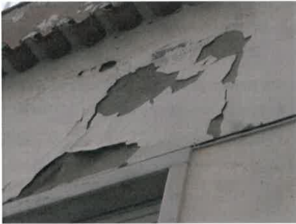
Foto n.º 3 – fachada norte, falta de pintura
