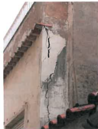
Foto n.º4 – fachada norte, fissuras
