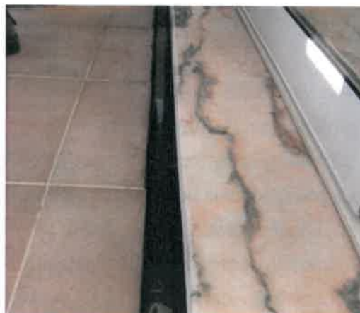
Foto n.º 4 – Caleira do terraço da fração 15 andar
