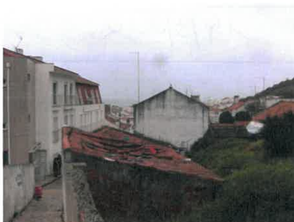
Foto n.º 1 – Abatimento das coberturas e panos de fachada sem revestimento
