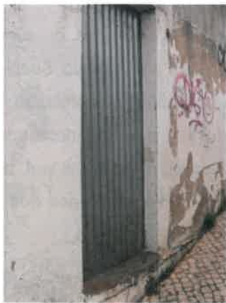
Foto n.º 2 – Vão de porta de acesso e falta de pintura do muro
