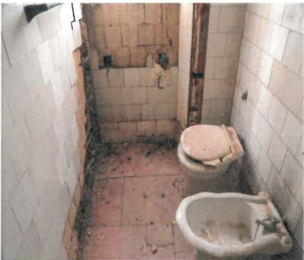
Foto n.º 7 – Instalação sanitária
