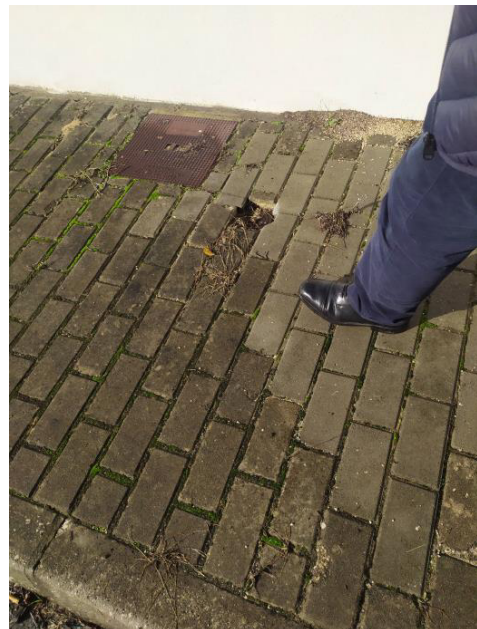
Foto n.º6 – Caixas desniveladas
