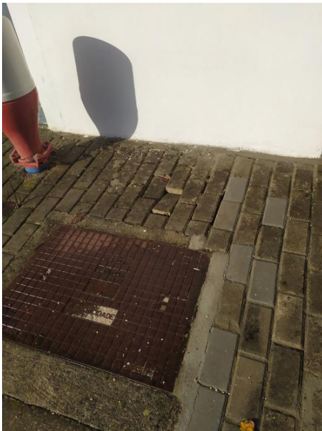
Foto n.º5 – Pavimento irregular
