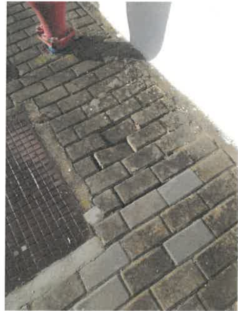
Foto n.º4 – Pavimento Irregular
