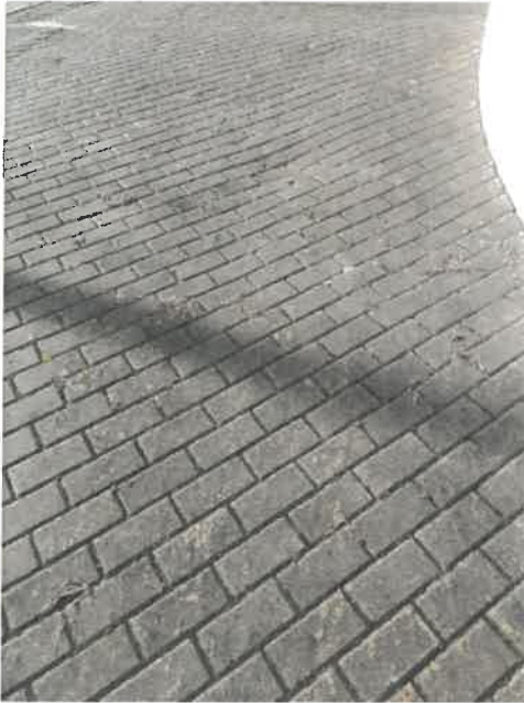
Foto n.º3 – Abatimentos no pavimento
