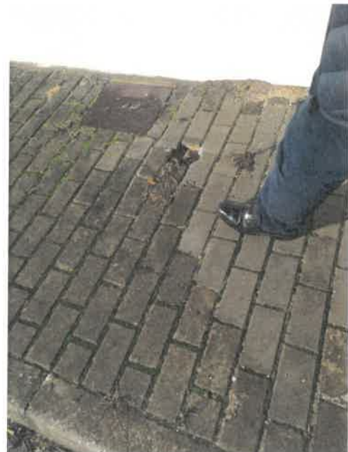
Foto n.º6 – Caixas desniveladas
