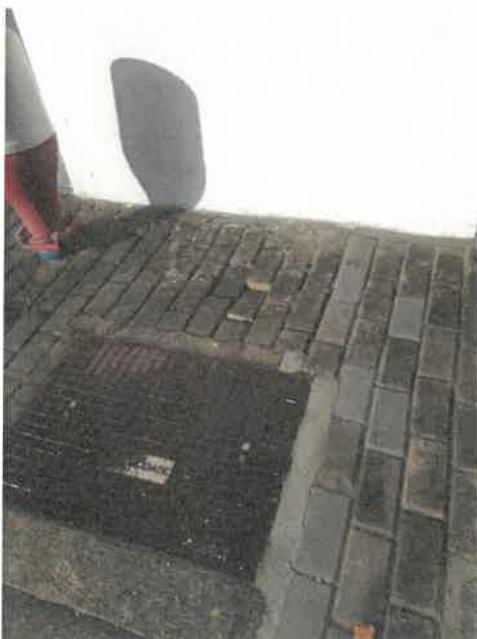
Foto n.º5 – Pavimento irregular
