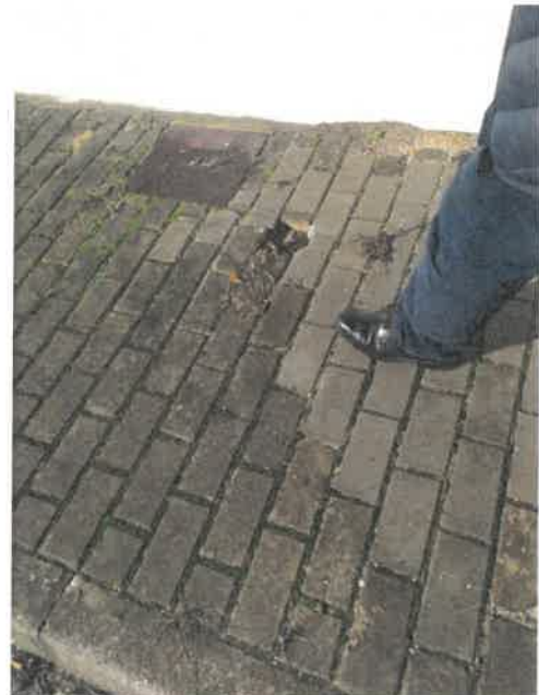
Foto n.º6 – Caixas desniveladas
