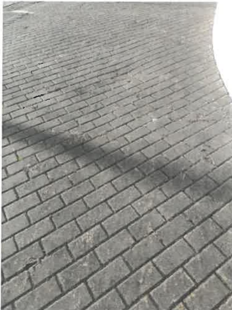
Foto n.º3 – Abatimentos no pavimento
