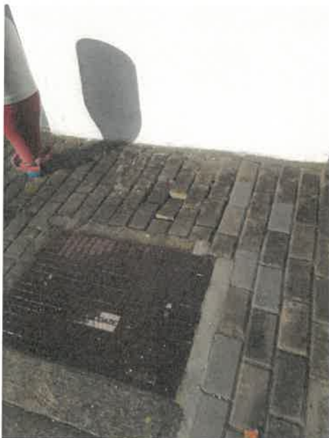
Foto n.º5 – Pavimento irregular
