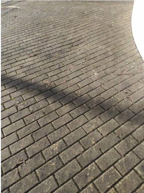
Foto n.º3 – Abatimentos no pavimento
