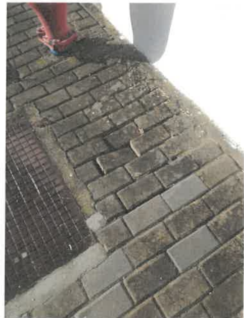
Foto n.º4 – Pavimento Irregular
