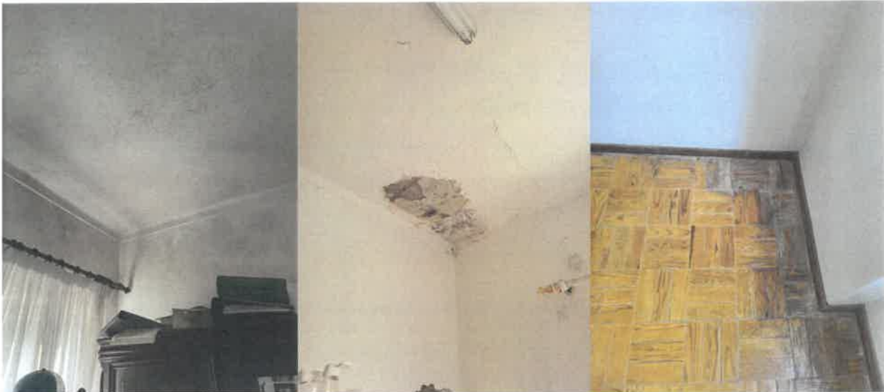
Foto 1 - tetos e paredes com bolor Foto 2 - Revestimento do teto da IS Foto 3 - pavimentos
